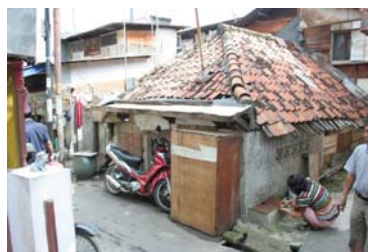
(b) Mangga dua 地域に地盤沈下
